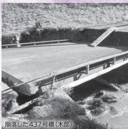
崩落した437号橋(木部)
