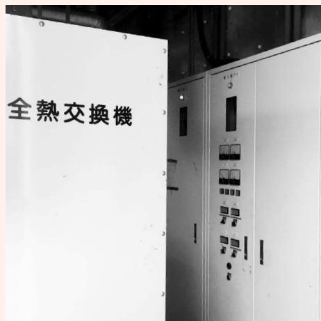
老朽化が進む伝統工芸会館の空調設備。
