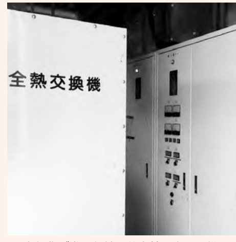
老朽化が進む伝統工芸会館の空調設備。
