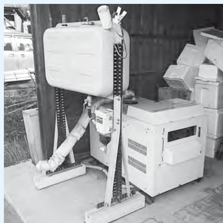
廃食用油活用用の防音型インバータ発電機 （7キロワット）。
