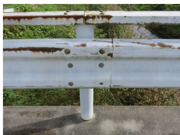
ガードレールの変形【Ⅱ】
