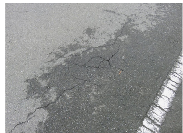
舗装のひびわれ【Ⅱ】
