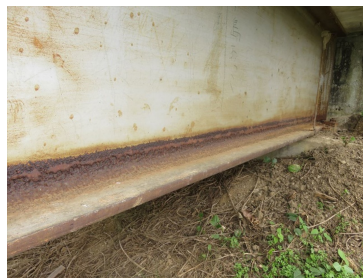
鋼桁の腐食【Ⅱ】
