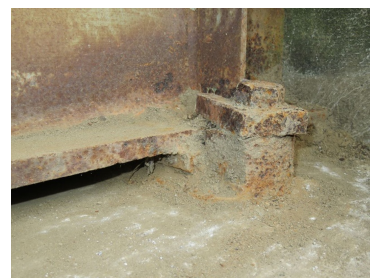
支承の腐食【Ⅱ】
