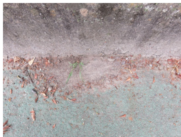
路面の土砂堆積【Ⅱ】
