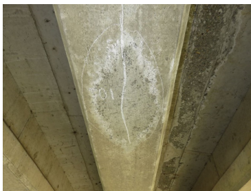
コンクリート桁のひびわれ【Ⅱ】
