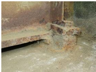
支承の腐食【Ⅱ】
