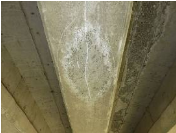
コンクリート桁のひびわれ【Ⅱ】
