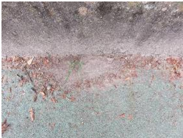
路面の土砂堆積【Ⅱ】
