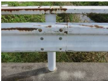
ガードレールの変形【Ⅱ】
