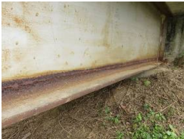
鋼桁の腐食【Ⅱ】
