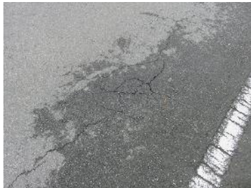
舗装のひびわれ【Ⅱ】
