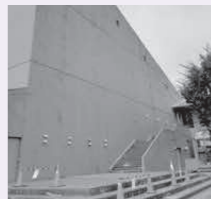
耐震に不安が残る大ホール棟
