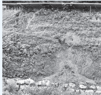
法面の崩れた大塚地内の太陽光発電事業所
