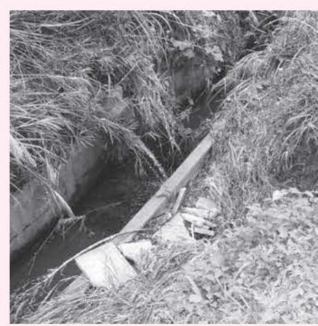
台風で被害を受けた水路。防災時には、住民も職員も相互に助け合う仕組みづくりを。
