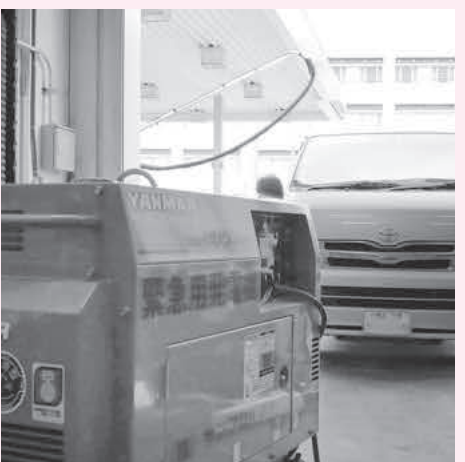
発電機を備えていて、停電時でも給油可能な住民拠点SSは、近隣には1社もない。
