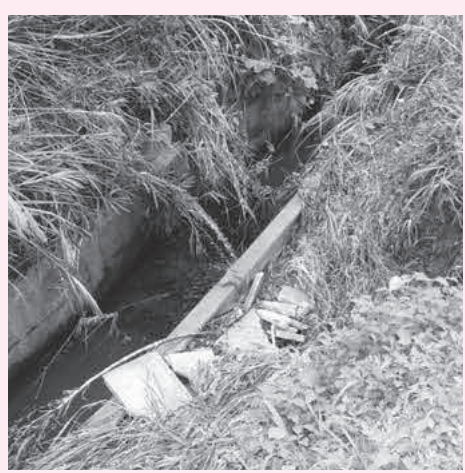
台風で被害を受けた水路。防災時には、住民も職員も相互に助け合う仕組みづくりを。
