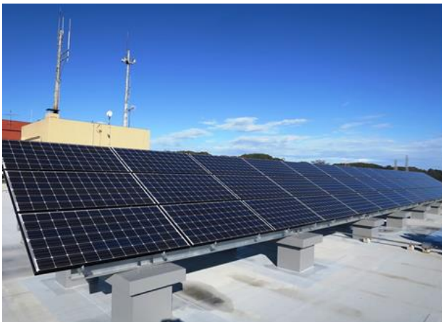
庁舎屋上に設置した太陽光パネル
