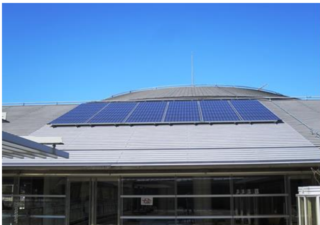
総合福祉センターの屋根に設置した太陽光パネル
