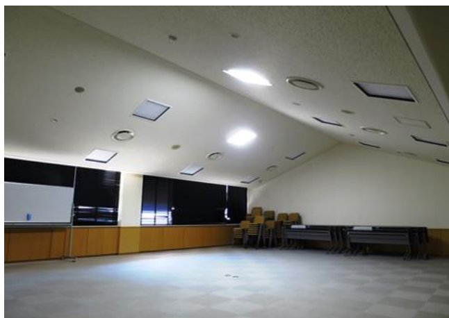
蓄電池からの防災用電源が利用できる 総合福祉センター 研修室
