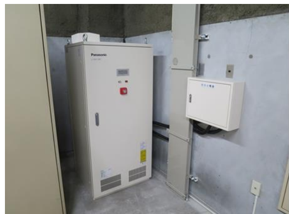
庁舎地下に設置した蓄電池
