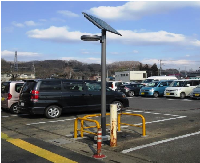
ソーラー付 LED 街路灯を庁舎及び 総合福祉センターに設置
