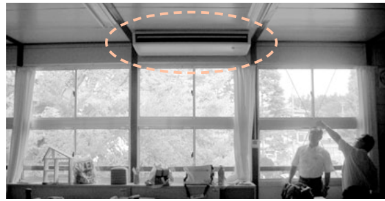
西中学校仮設校舎教室に設置されているエアコン
