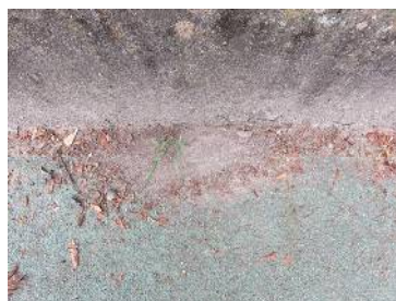
路面の土砂堆積【II】
