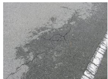
舗装のひびわれ【II】
