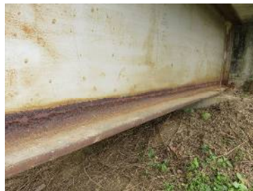
鋼桁の腐食【II】
