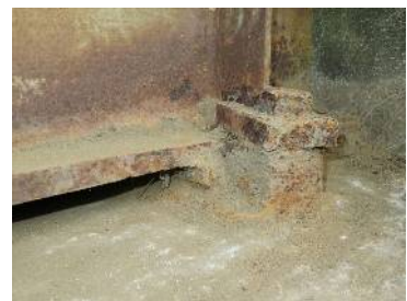
支承の腐食【II】
