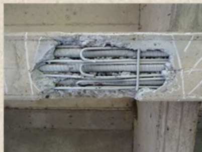
鉄筋露出状況
